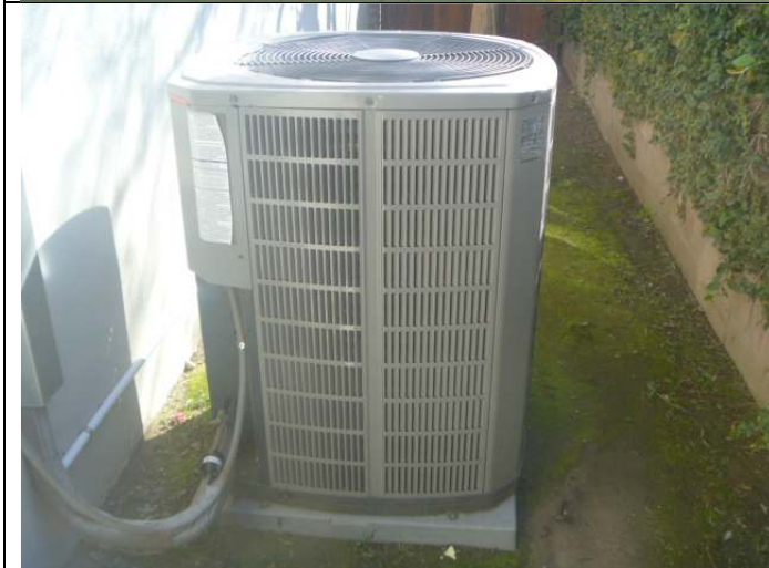
Air conditioner condensing unit.
