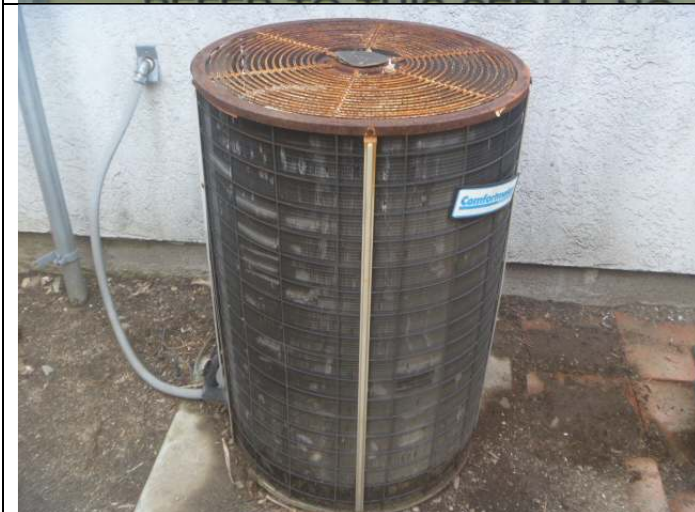
Air conditioner condensing unit.
