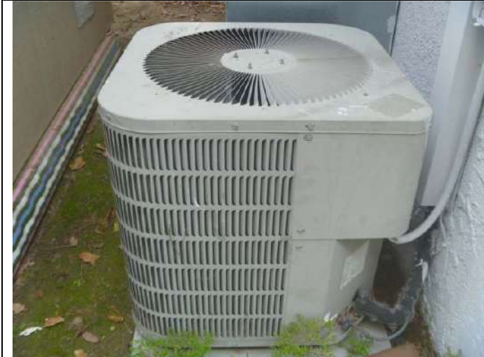
Air conditioner condensing unit.
