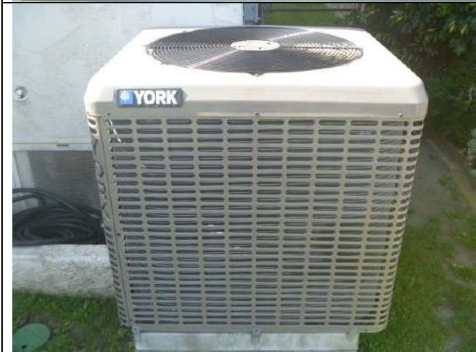
Air conditioner condensing unit.
